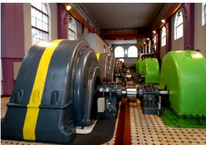
Vista de l'interior de la nau d'alternadors de la central.
